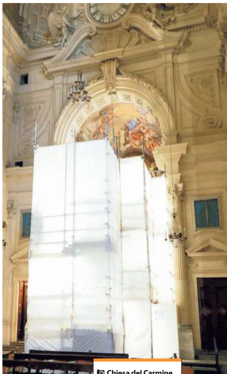
Chiesa del Carmine Il cantiere pronto per le operazioni di restauro del ciclo pittorico della Cappella Brancacci. In alto a sinistra, il sindaco Nardella
